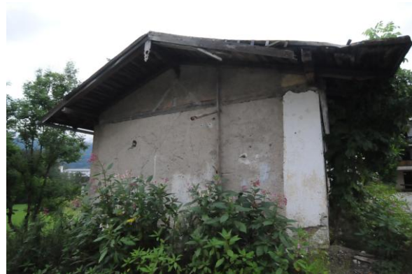
Abb. 13: Die Windbretter als mögliches Quartier im Außenbereich sind verrottet. Eine Nutzung durch Fledermäuse ist unwahrscheinlich.
