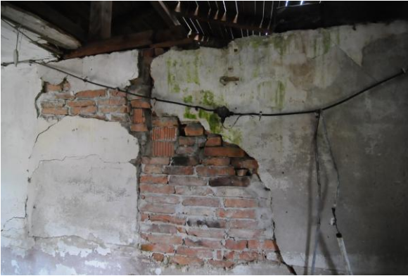
Abb. 12: Die Risse im Mauerwerk wurden soweit möglich auf Fledermäuse kontrolliert.
