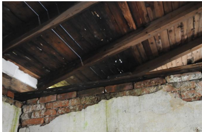
Abb. 11: Das Dach ist an vielen Stellen offen und undicht.
