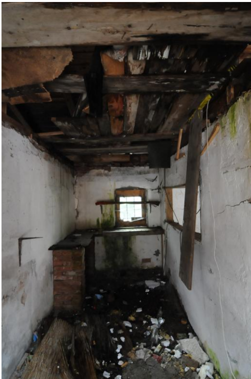
Abb. 10: Decke und Innenräume sind marode und als Fledermausquartier ungeeignet.
